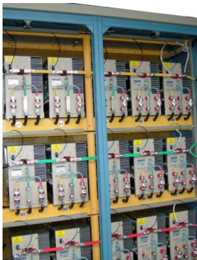
Рис. 12 Шкаф силовых блоков и управления. (вид спереди шкафа при открытых дверях)
