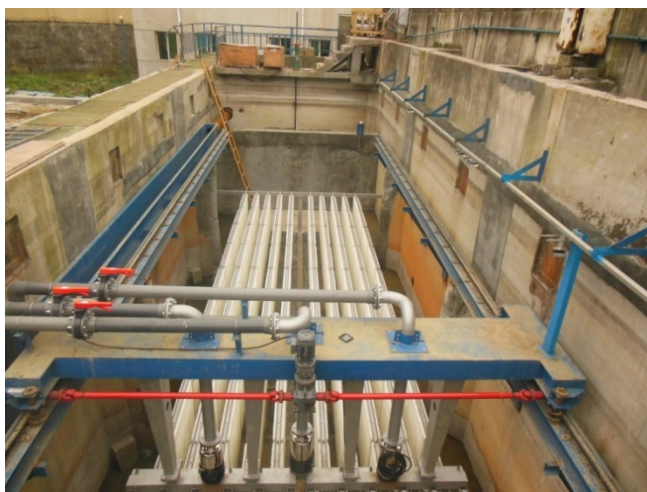
Рис № 05. ВПК ТФ установленный в ж/б емкости.
